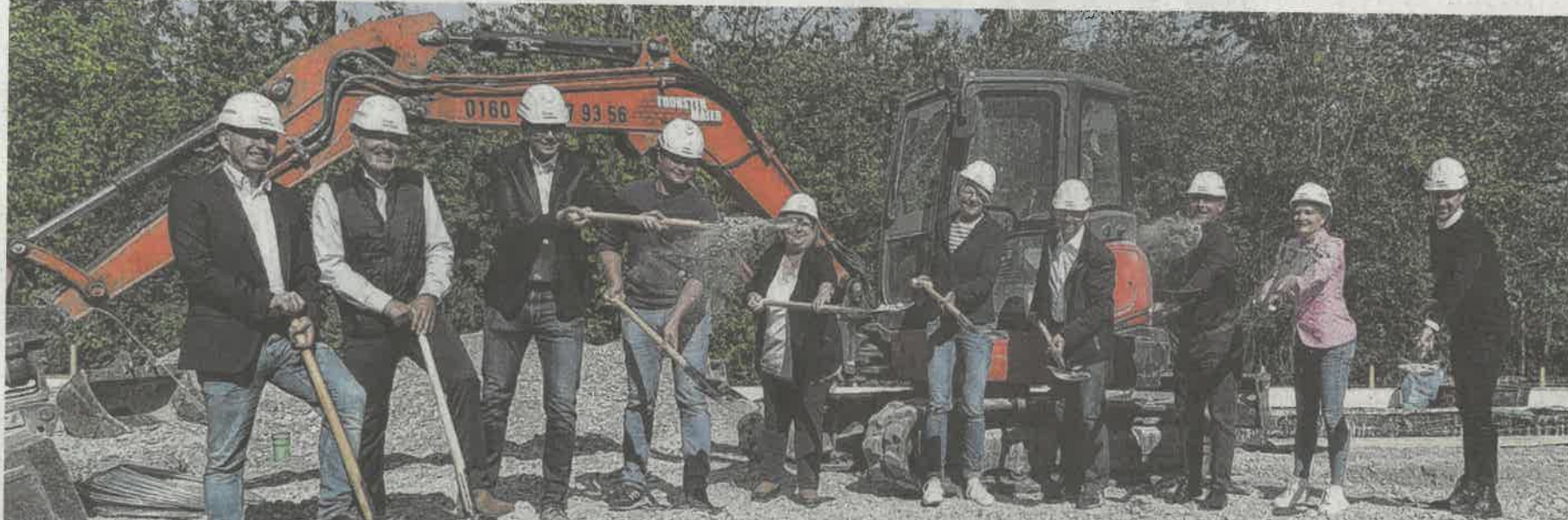
Die Fläche ist bereits geschottert, der Bagger steht bereit, rechts im Hintergrund sind auch schon Fundamente betoniert. Der Spatenstich am stationären Hospiz hat symbolischen Charakter.
